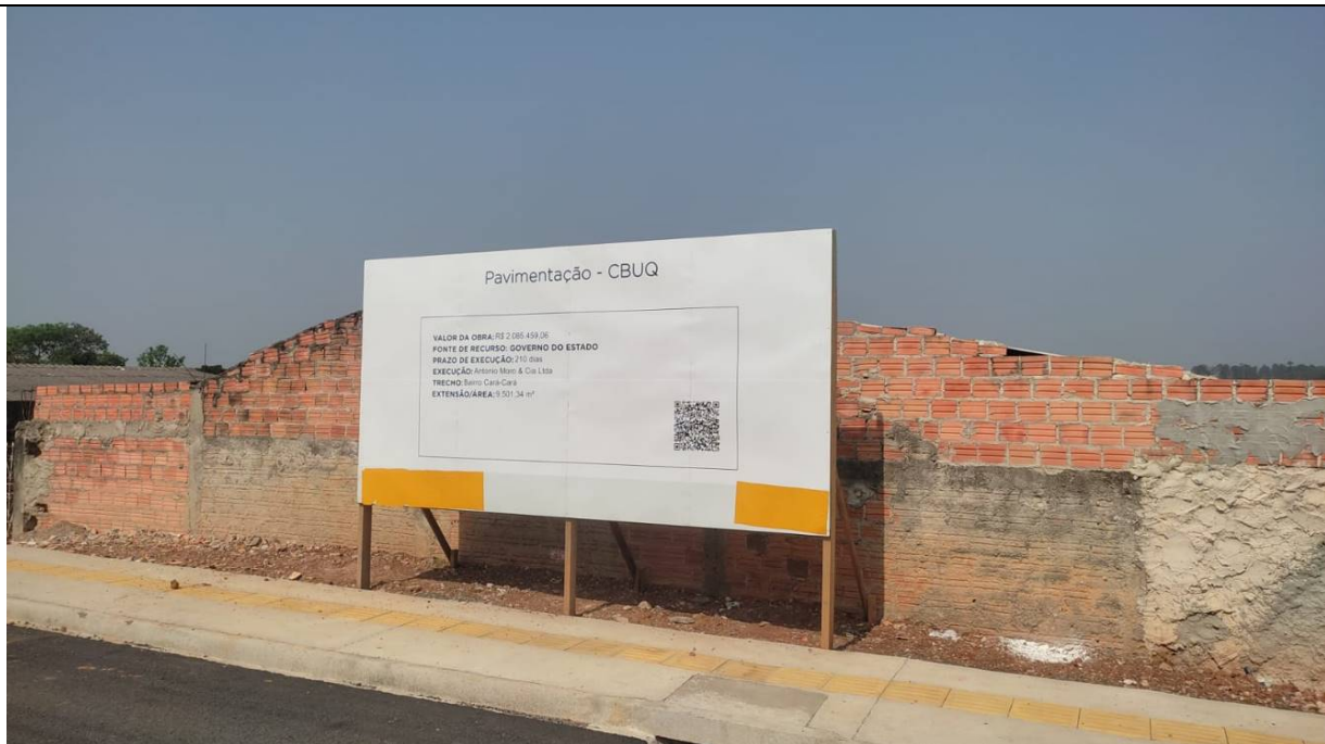
Placa de obra – SAM 198 – L.3. Placa de obra em bom estado, porém coberta por adesivo.
