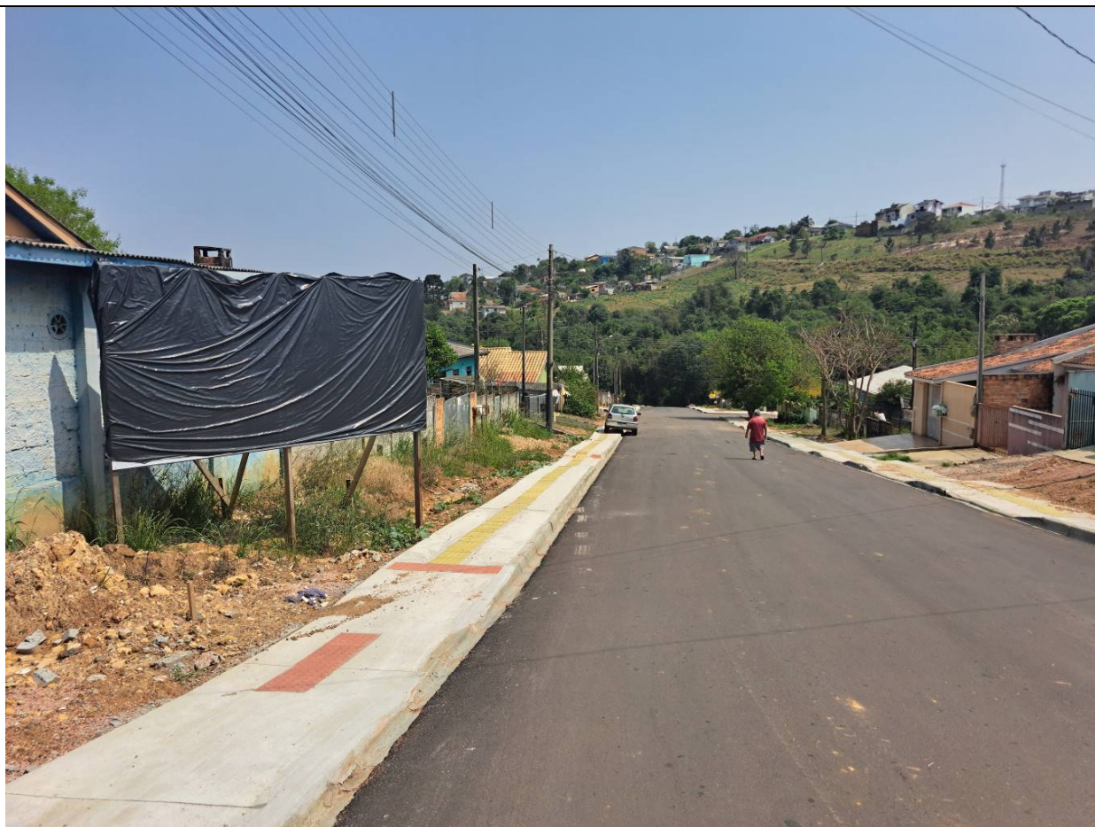
Placa de obra – SAM 216 – L.2. Placa de obra em bom estado de conservação, coberta por lona.
