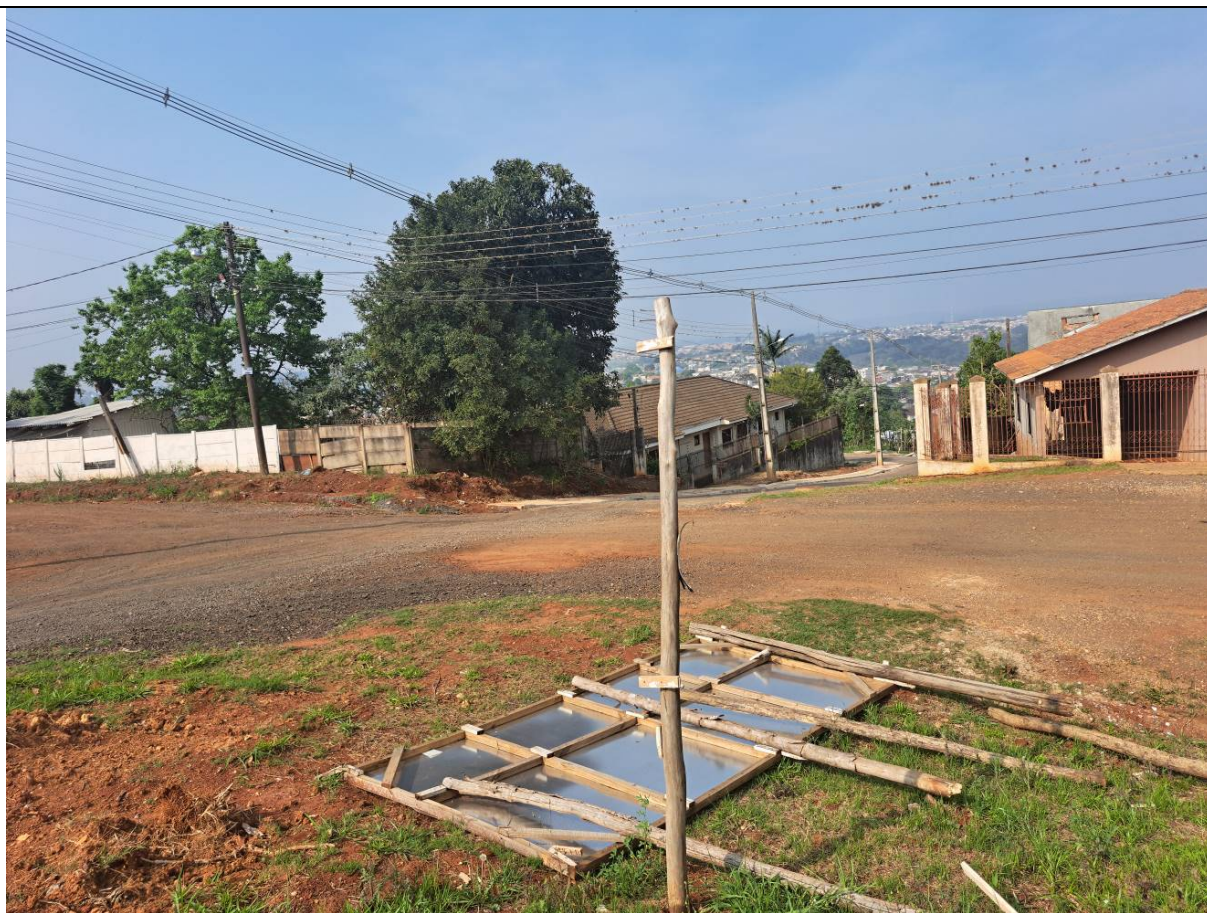
Placa de obra – SAM 209 – L.1. Placa de obra encontrada no chão e mal estado.
